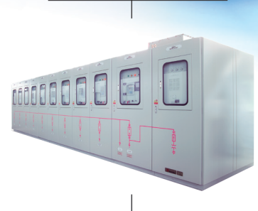
配電盤 Switchgear & Controlgear
